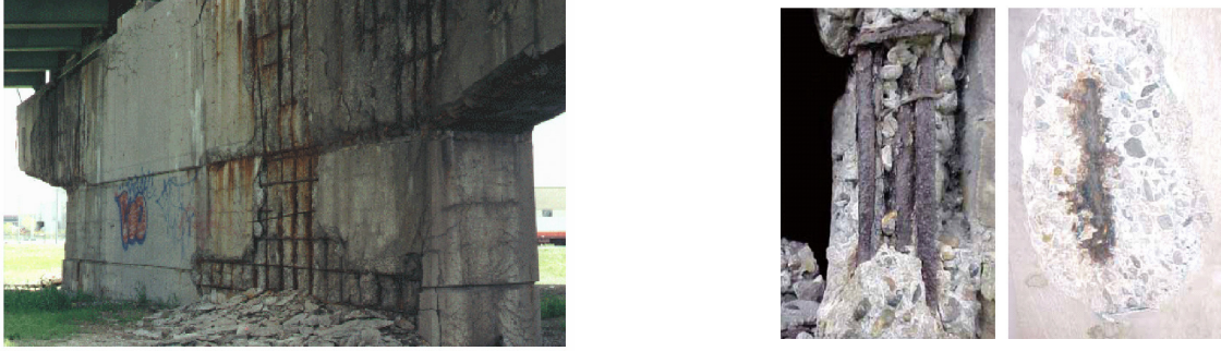
Resim 1: Korozyonun Zararlı Etkileri
